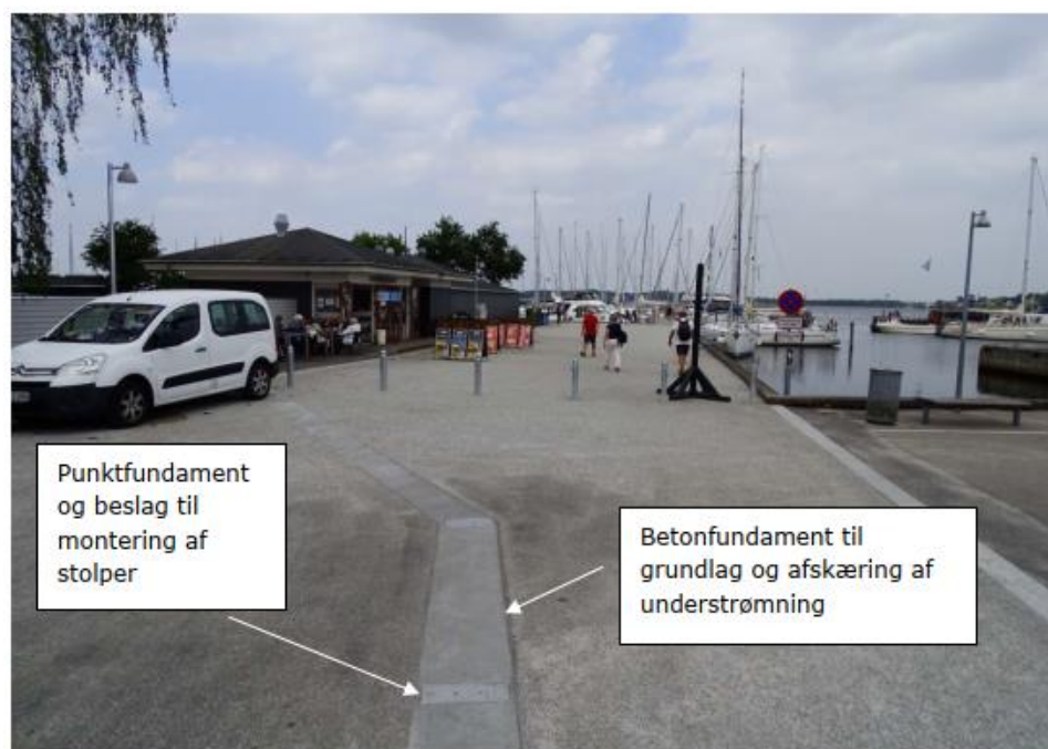
Fig. 5.15. Eksempel på synlig del af fundament til demonterbar højvandsmur fra Roskilde inderfjord.
